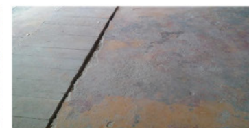
Підлога до ремонту
